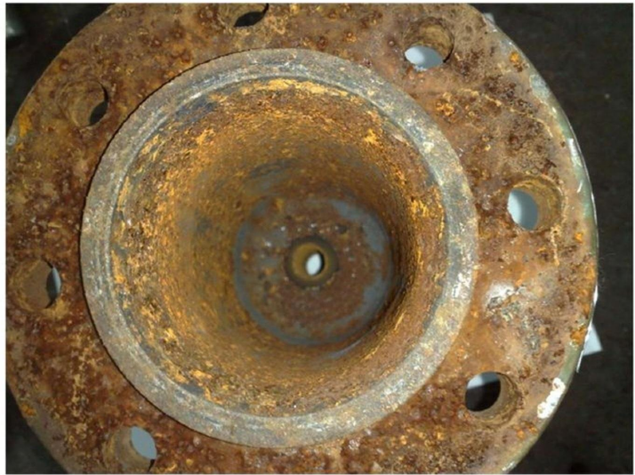
Corrosión debida a una atmósfera inapropiada para el tipo de material
