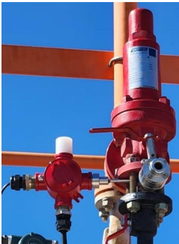
Válvula AERRE con el módulo VI instalado en campo.
